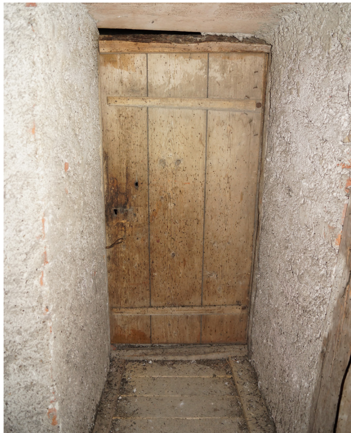
Slika 22: Prehod med zvonikom in podstreho na cerkvi Marijinega vnebovzetja v Prevaljah, ki naj ostane nespremenjen s špranjo nad vrati.
