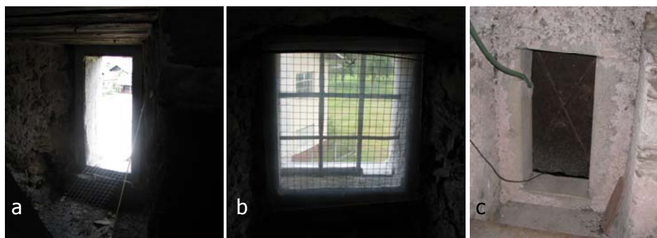
Slika 22. a) Odprta lina na zvoniku, ki jo netopirji verjetno uporabljajo za preletno odprtino. b) Zaprto in zamreženo okno za katerega se predlaga odstranitev mreže in pleksi stekla. c) Vrata na prehodu zvonik-podstreha s špranjo na spodnji strani (foto: Tea Knapič, 11.8.2012).
