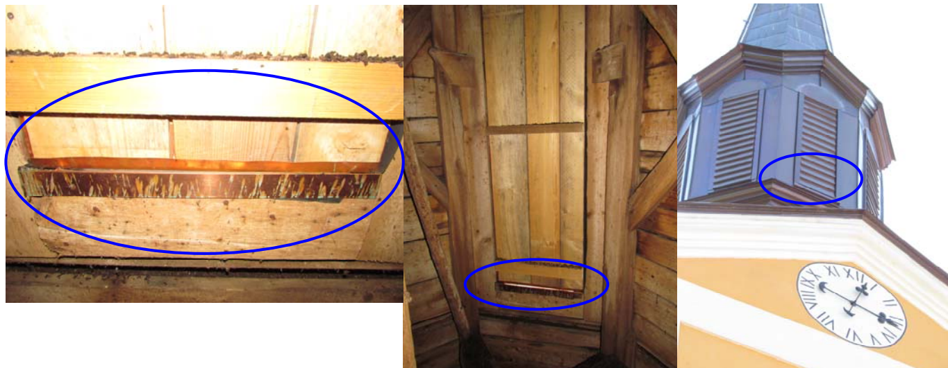
Slika 28. Obstoječa reža na loputi strehe zvonika je trenutno premajhna za vstop netopirjev. S (foto: Primož Presetnik, 26.5.2011)
