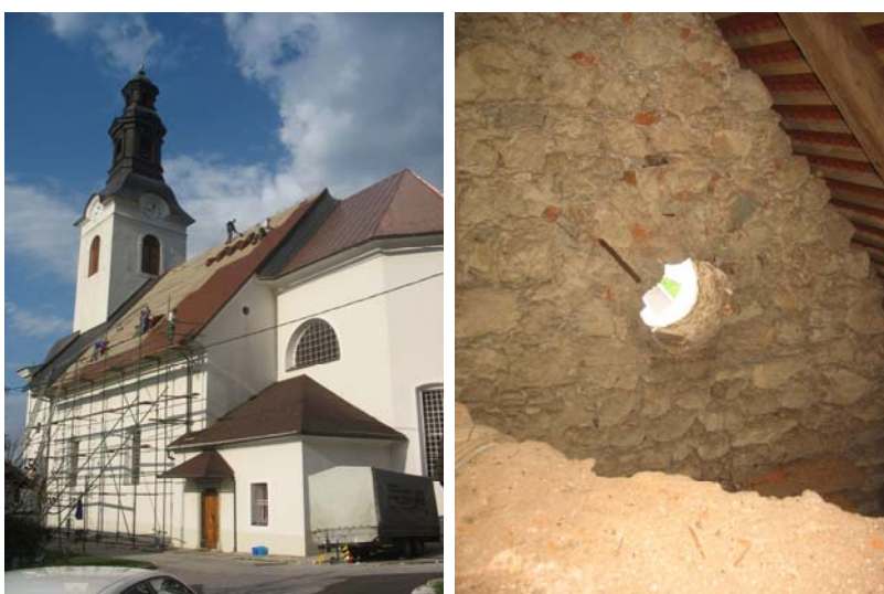
Slika 15. Prenovljena strešna kritina cerkve Žalostne matere božje v Breznici in na novo odprta lina (foto: Primož Presetnik, 11.9.2009).
