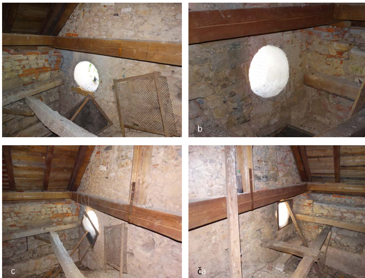
Slika 7: a in b) Odprto desno in levo (gledano proti oltarju) okroglo okno na podstrehi cerkve sv. Petra in Pavla v Brestanici (foto: Tea Knapič, 12. 6. 2015) in c ter č) zamreženi okni v letu 2016 (foto: Primož Presetnik, 18. 6. 2016).
