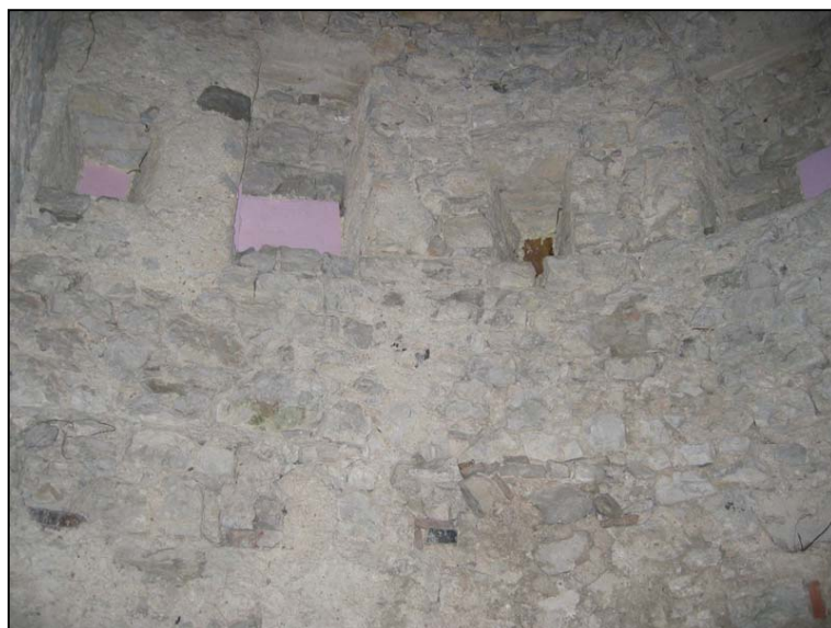
Slika 27. Zadelane line na rondelah. (Foto: A. Vidic, marec 2005)
