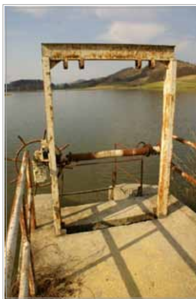
Slika 14: Nefunkcionalni dvižni mehanizem talne tablaste zapornice, ki jo nadomeščajo fiksne prekladne zapornice s fino lovilno rešetko za ribe
