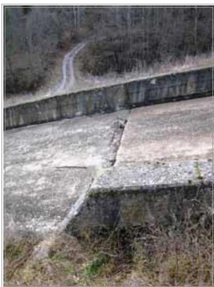
Slika 16: Poškodbe betonske površine in diferenčni posedki konstrukcijskih stikov na prelivni drči visokovodnega preliva
