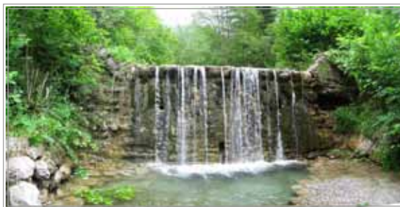
Slika 16: Mlinca pri Dovjem - stara, močno dotrajana zaplavna pregrada – razpadanje betona trupa pregrade, odnesen tlak v podslapju (pregrada je bila v letu 2010 predzidana, podslapje pa sanirano) (foto arhiv VGP d.d. 2008)
