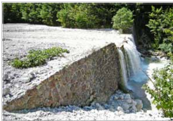
Slika 17: Pišnica v Klinu - poškodovani preliv velike zaplavne pregrade (pregrada je bila v letu 2012 sanirana) (foto arhiv VGP d.d. 2010)
