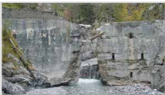
Slika 20: Hudournik Belca v zaledju - po celotni višini erodiran trup zaplavne pregrade, material iz zaplavka je bil postopoma odplavljen (foto arhiv VGP d.d. 2006)
