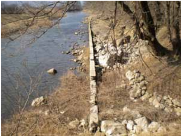
Slika 9: Sanacija prelivnega polja Milavčevi ključi številka 31 in 32 – pred izvedbo (foto: I. Lampič)
