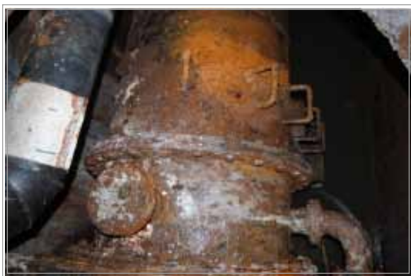
Slika 15: Dotrajani jekleni cevovod na visokovodnem izpustu
