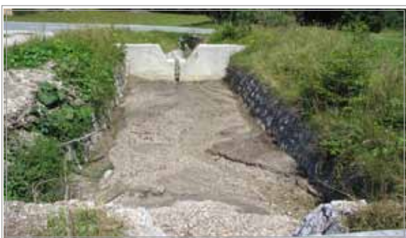
Slika 9: Hudournik Križnica v Podkorenu - obzidan zaplavni usedalnik oziroma peskolov z vtočnim in iztočnim pragom (foto arhiv VGP d.d. 2012)
