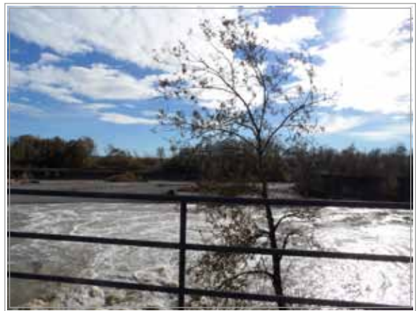
Območje porušitve desne brežine odvodnega kanala v Forminu (A. Suhadolnik)
