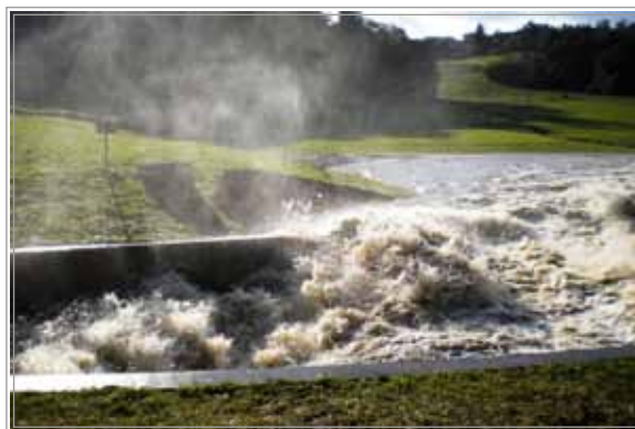
Slika 12: Primer neustrezne zasnove disipacijskega objekta na visokovodnem izpustu – posledica je pojav retrogradne erozije nožice pregrade že v normalnih obratovalnih razmerah.
