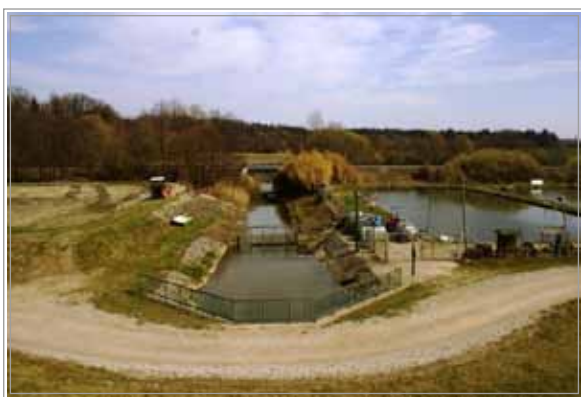
Slika 10: Na pragu podslapja visokovodnega izpusta in na iztočnem kanalu so nameščene lovilne rešetke za ribe, ki pomenijo oviro pri prevajanju vode in potencialno grožnjo za varnost železniške proge dolvodno.
