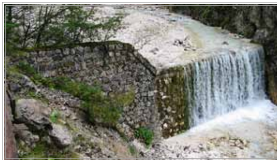
Slika 10: Hudournik Martuljek - zaplavna pregrada na iztoku soteske izpod spodnjega Martuljskega slapu – stara pregrada leži na zavarovanem območju, do nje pa tudi ni ustreznega dovoza, zato ni predvidena za praznjenje (foto arhiv VGP d.d. 2007)
