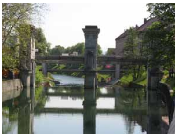
Slika 2. Zapornice in ribja steza pri Ambroževem trgu
