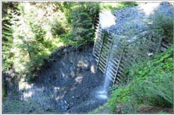
Slika 18: Hudournik Suhelj v zaledju - spodkopana zaplavna pregrada iz armiranobetonskih kašt, polnjenih s kamnom (pregrada bo predvidoma sanirana v letu 2013) (foto arhiv VGP d.d. 2011)
