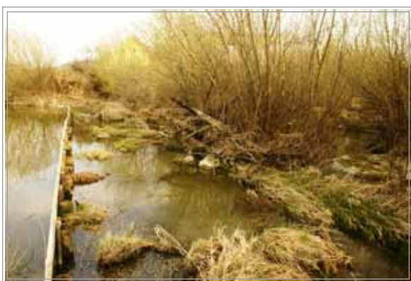
Slika 11: Na pragu visokovodnega preliva, ki že sam po sebi zaradi nevzdrževanja pomeni grožnjo za varnost pregrade, je postavljen fiksni leseni provizorij z namenom dviga obratovalne gladine za potrebe bližnje mHE.
