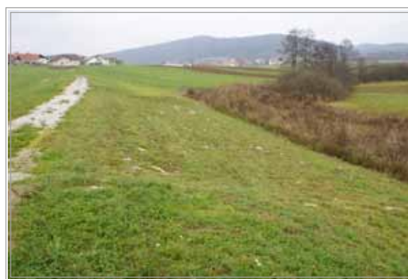
Slika 13: Primer neustrezno zasnovanega visokovodnega preliva čez nasuto pregrado brez ustrezno zasnovanega disipacijskega objekta in urejene odvodnje prelivne vode pod pregrado.
