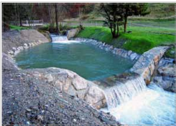
Slika 8: Hudournik Selnica nad vasjo Selce pri Železnikih - obzidan zaplavni usedalnik z vtočnim in iztočnim pragom (foto arhiv VGP d.d. 2010)
