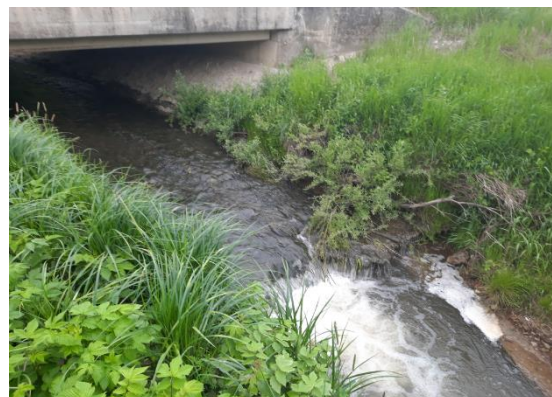
Slika 25. Prag pod cestnim mostom in vodotok Ličenca dolvodno od pragu, lokacija L1: Lušečka vas (DRSV, 2021).
