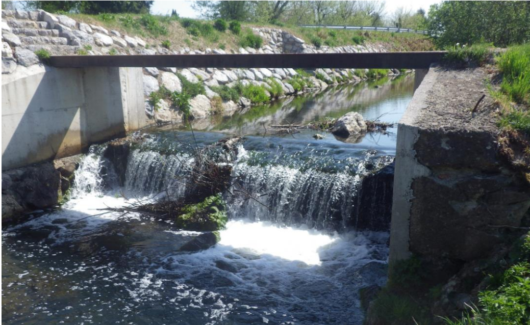
Slika 2: Za piškurje neprehodna prečna pregrada na Vzhodni Ložnici (ZZRS, 2020).
