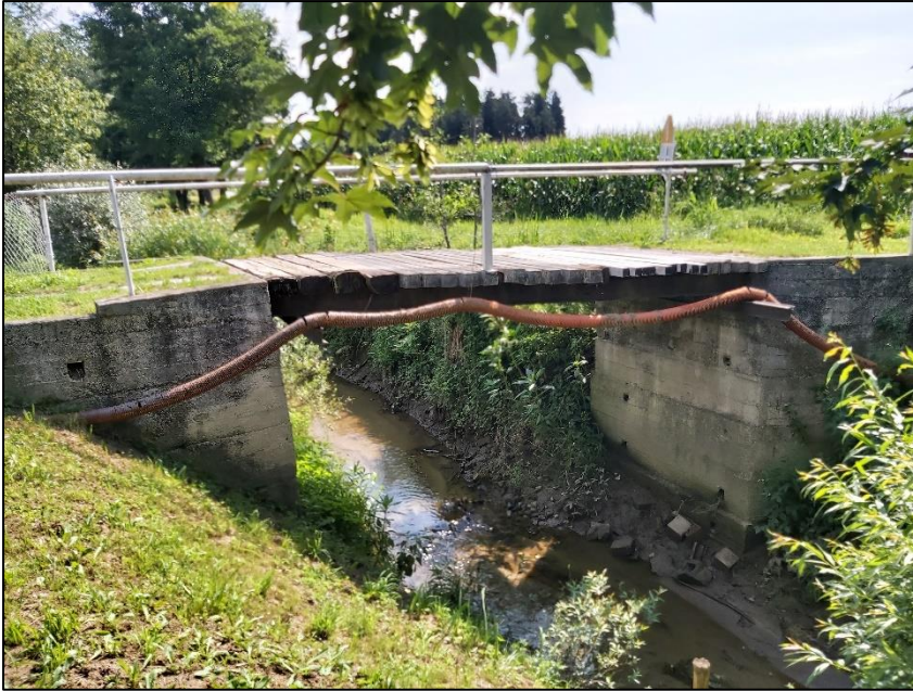
Slika 6 Primer nestrokovne izvedbe mostu na vodotoku Vzhodna Ložnica, evidentirane s popisom VONU v okviru projekta LIFE-IP NATURA.SI (DRSV, 2020)
